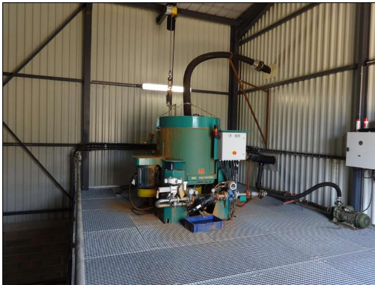
Photographie 23 : séparateur densimétrique de marque Knelson présent sur le site d'ICF Quartz de Dordogne
