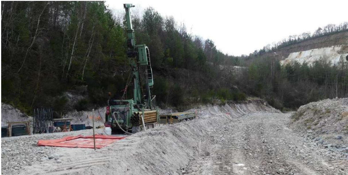
Illustration : Foreuse et matériel en place pour la campagne de sondages Phase 1, le long d'une piste existante – Echassières février 2022 - source photographique : Mica Environnement
