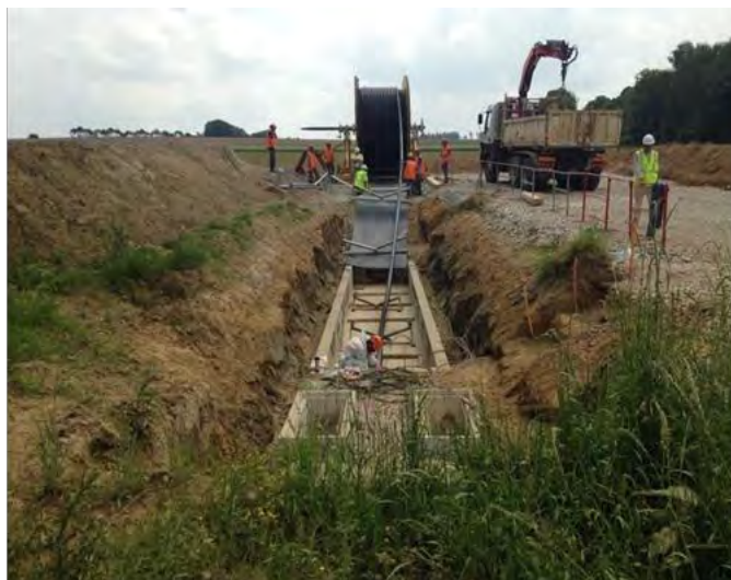
Figure 44 : Chambre de jonction et puits de terre au premier plan (Source - RTE)
