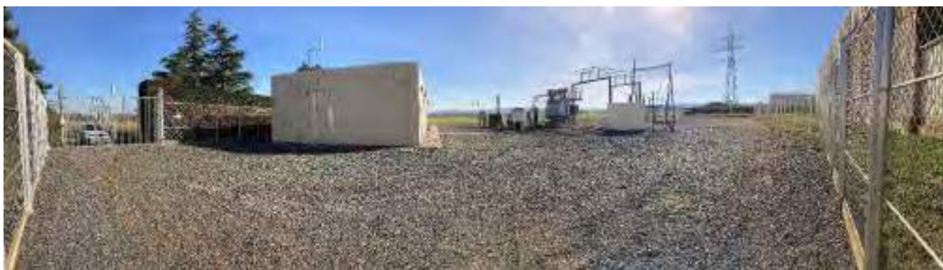
Figure 45 : Poste RTE de Bellenaves 63 000 Volts (Source - RTE)
