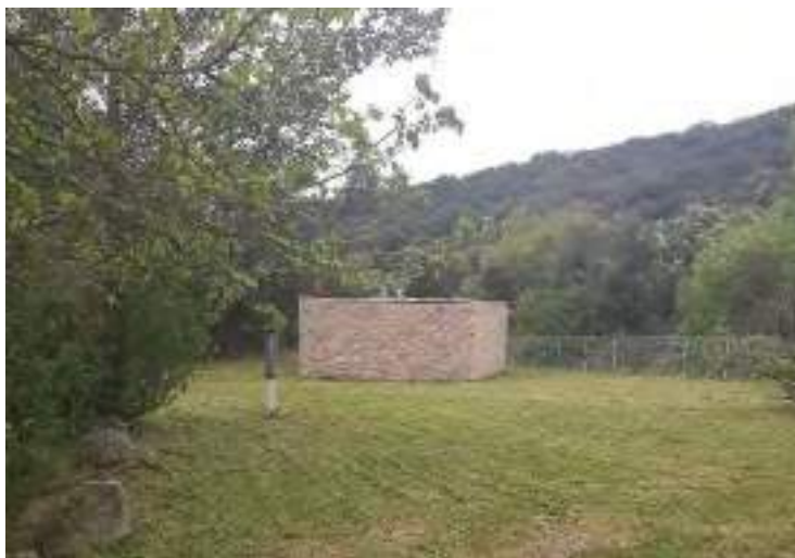
Figure 51 : Exemple de station de pompage (Source – IRH)
